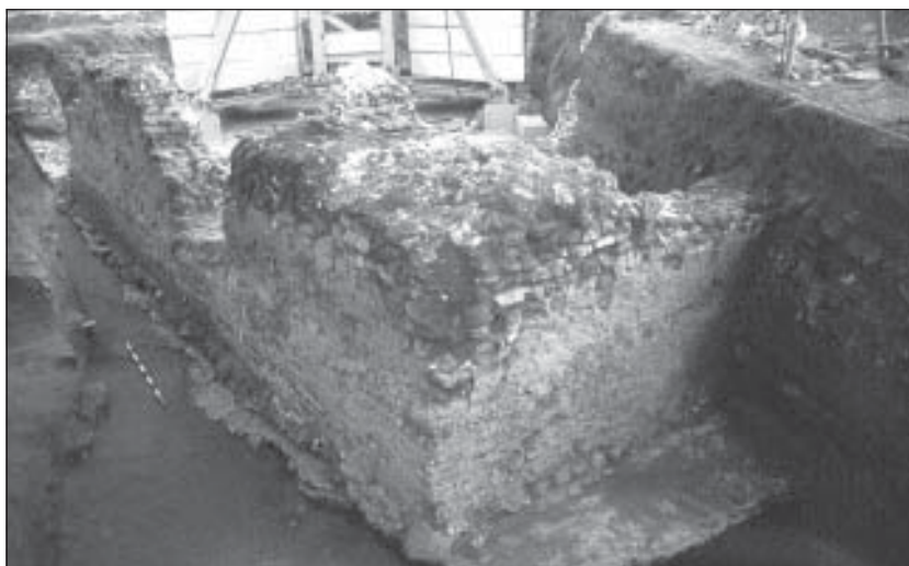
● Esquina exterior de los muros que delimitan el conjunto. Es visible la zapata de cimentación
